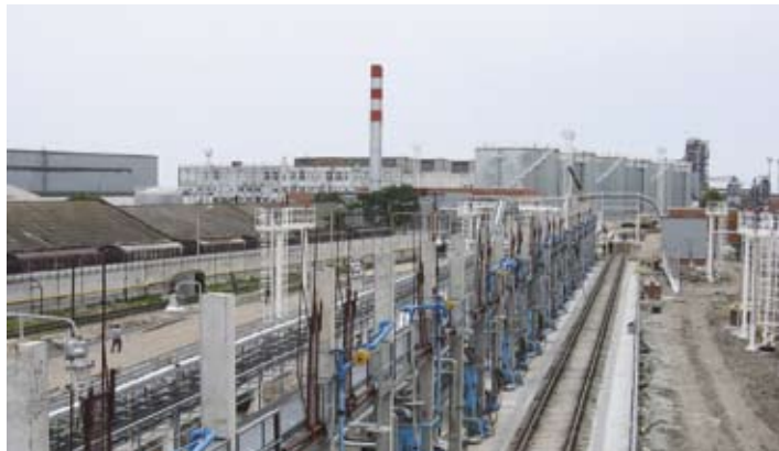
На фотографии: общий вид на эстакаду слива мазута на территории ОАО «Таганрогский судоремонтный завод»
